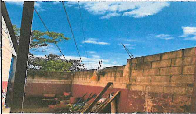
Foto 1: Reparación de muro perimetral, las columnas se encuentran dañadas, debido al agua que le cae constantemente
